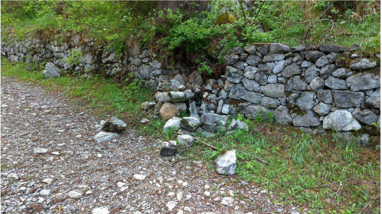
MURO A SECCO DA RIPRISTINARE (PUNTO 12)
